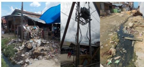
Gambar 6. Kondisi Infrastruktur Pasar
