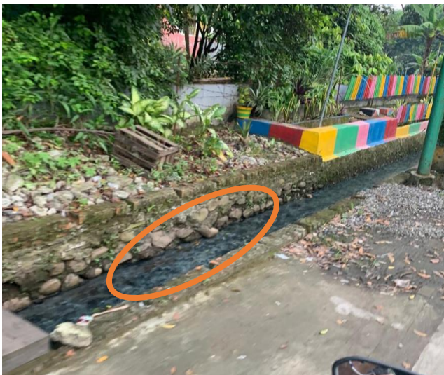
Gambar 6. Saluran Drainase Terlalu Kecil
