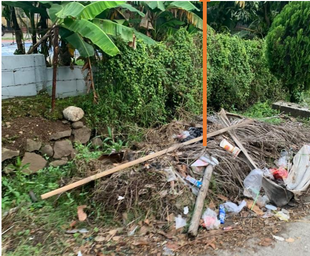
Gambar 5. Kondisi pada sebelah drainase
