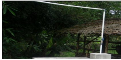
Gambar 8 Pipa Saluran Gas
