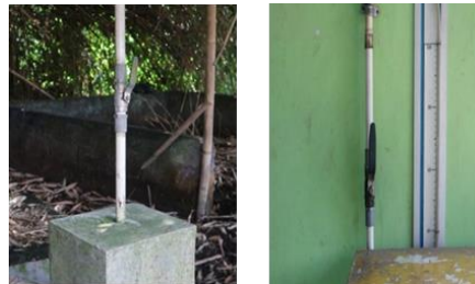
Gambar 9 Keran Dekat Bak Reaktor dan Pada Manometer
