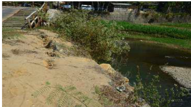
Gambar 3.14. Retakan jembatan di Desa Pagutan, Kecamatan Arjosari Akibat Erosi Sungai Grindulu
