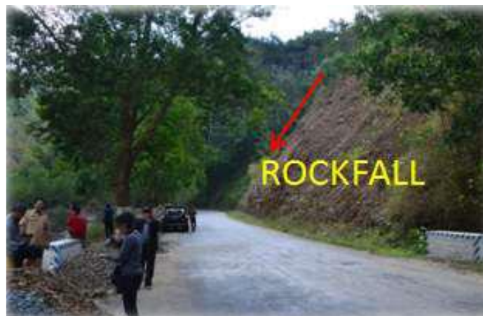
Gambar 2.2. Longsor Batuan di Desa Gemaharjo Kecamatan Tegalombo Sumber: Dokumentasi Penelitian Tanggal 18 Agustus 2014
