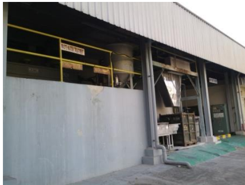
Gambar 4.1 Unit Pengolahan Air Limbah
