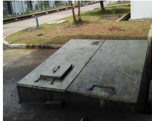
Gambar 3.1 Bak Penyimpanan Limbah Cair PT. YTK Indonesia.
